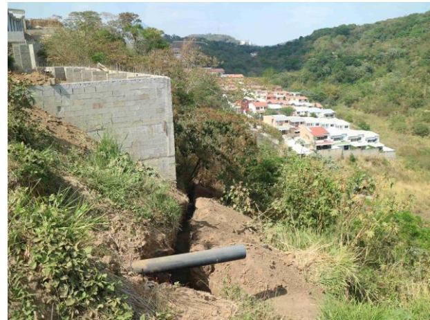
Fig 25: Tubería de desagüe que termina sobre ladera inestable.
