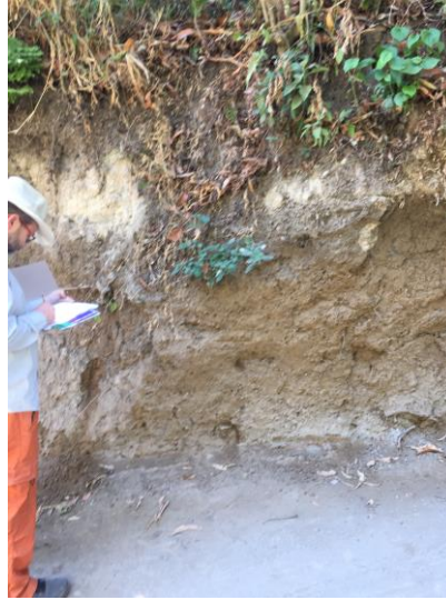
Fig. 40 Tobas meteorizadas afectadas por la reptación
