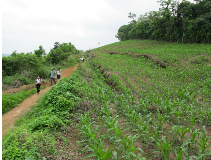
Foto 32 Cabecera de deslizamiento poligenético con las grietas hasta trincheras como un inicio de deslizamiento de la ladera en la laterita sector del Bálsamo
