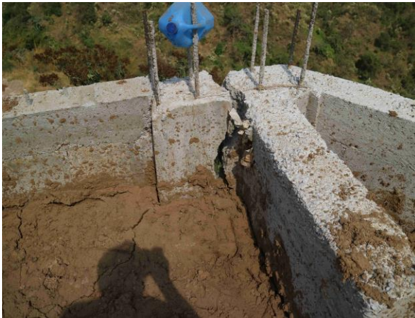
Fig 24: Muro de contención diseñado inadecuadamente con grietas debido a inestabilidad del suelo.
