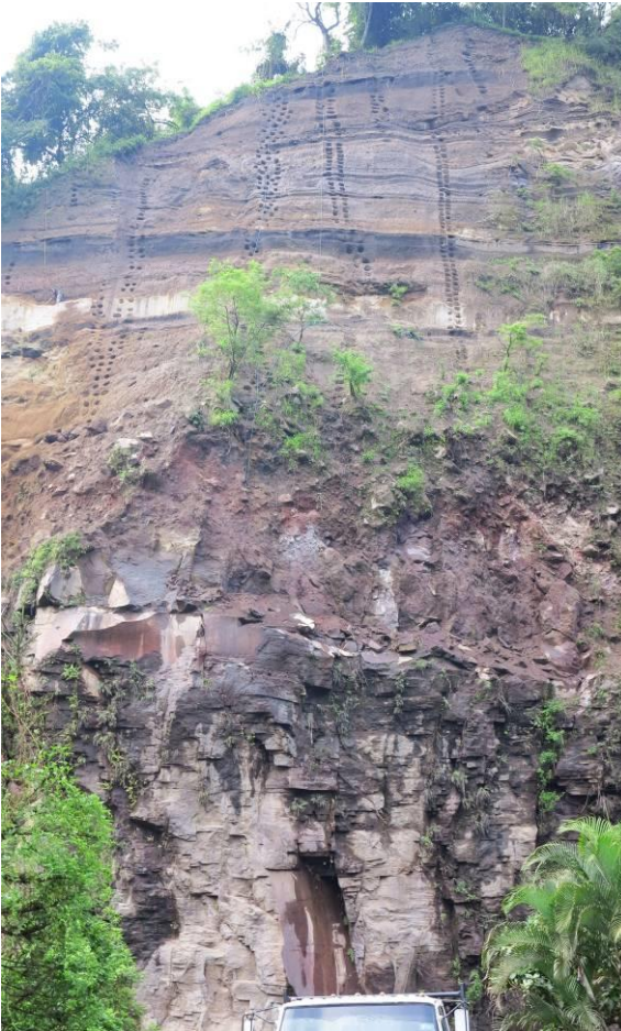
Fig. 41c Flujo de lava entrecañon cubierto por una sucesión de horizontes de tefra Boquerón incluyendo TB4 (blanco), Las Lajas (+13.7027548, -89.3381122)
