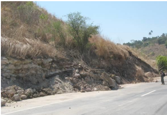
Fig. 53c Frente de deslizamiento en Carretera de Oro 2009 (+13.7363105, -89.1587812)
